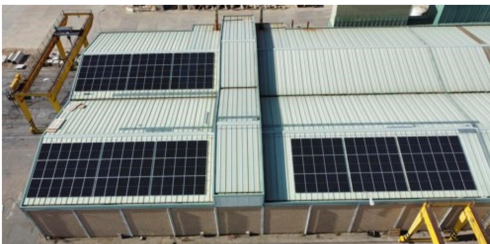
Placas Fotovoltaicas de la Planta de Prefabricados de hormigón de Mansilla de las Mulas en León
