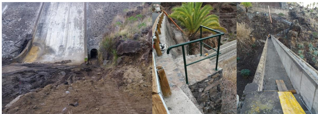
Imágenes 5, 6 y 7. Vista parcial acceso rodado a galería de fondo y sendero acceso a coronación.
