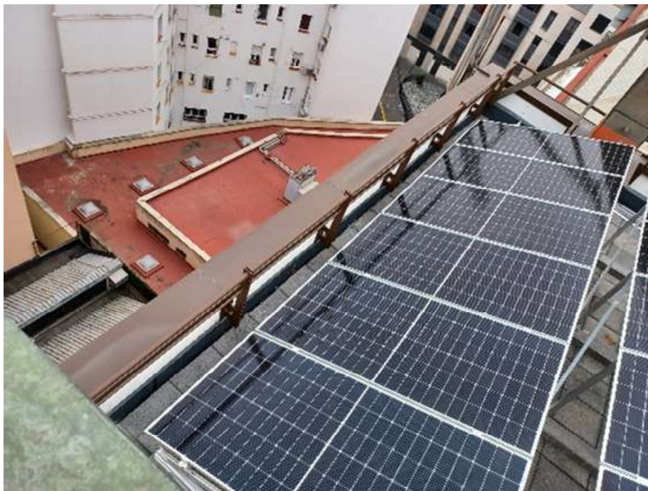
Instalación fotovoltaica de las instalaciones de Sede
