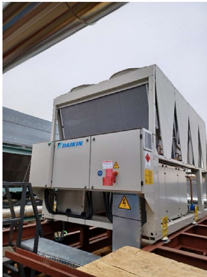
Nueva enfriadora instalada en el centro
