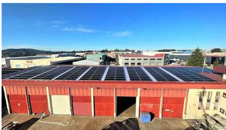
Instalación solar fotovoltaica en la sede del taller de la UT 1 en Santiago de Compostela.
